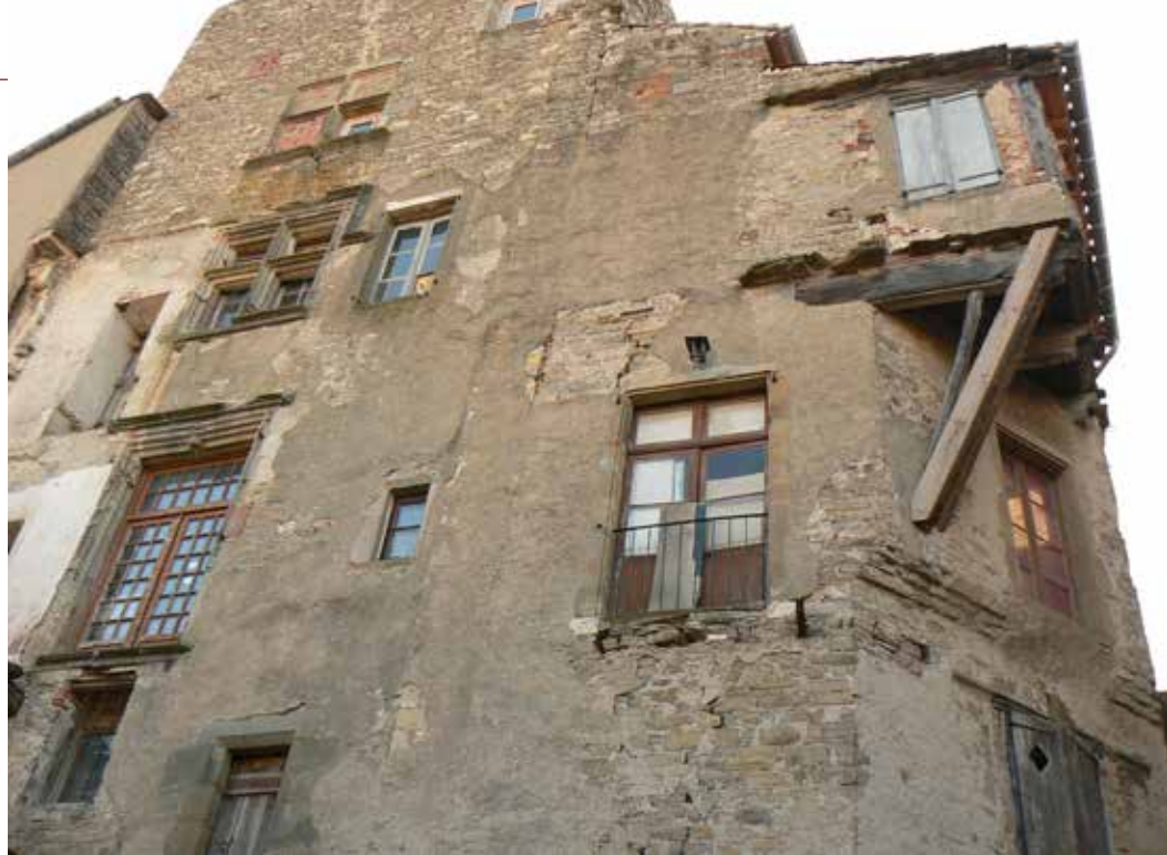
Se résoudre à démolir les immeubles où les travaux d'isolation sont infaisables.
